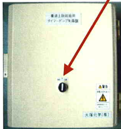
タイマーポンプ制御盤
